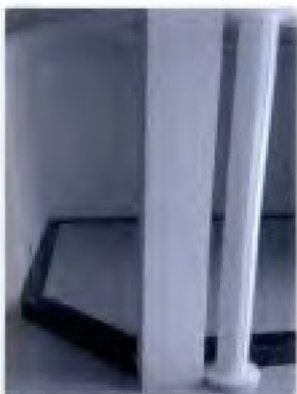
Figura 15 – Desnível na Sala de Estar
