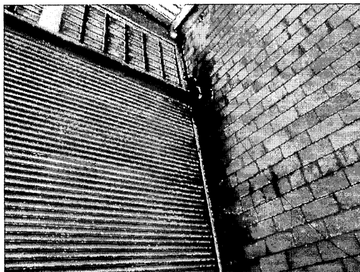
Figura 15 – Faixa da alvenaria com tonalidade mais escura, indicando umidade
