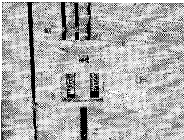
Figura 12 – Quadro de energia
